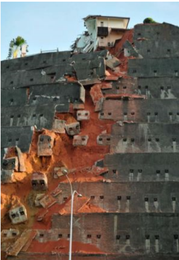
BAHAYA...Sebuah rumah yang hampir musnah akibat kejadian tanah runtuh yang berlaku di Bukit Setiawangsa, Kuala Lumpur malam Jumaat. - FotoBERNAMA
